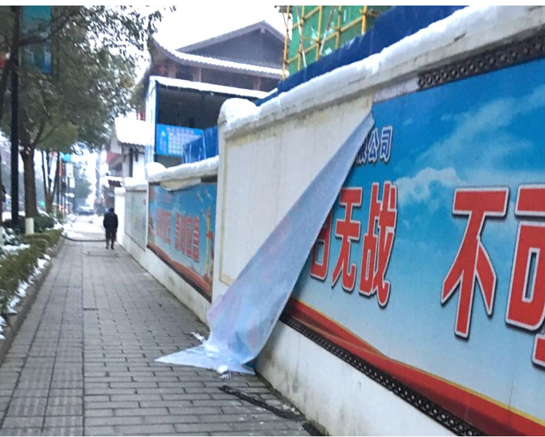
武陵源区宝峰路人防工程项目部宣传栏破损。
