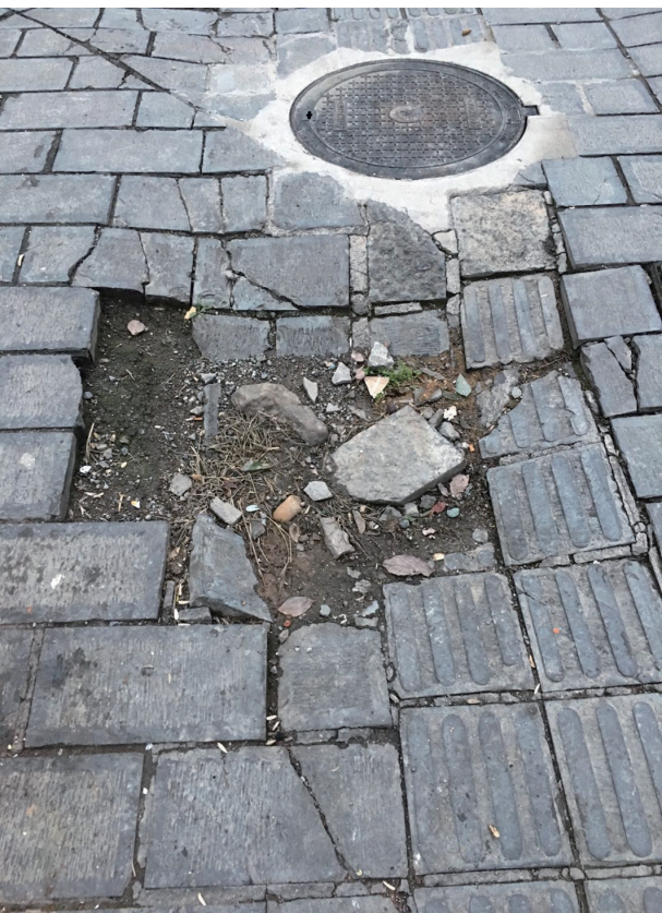
武陵源区宝峰路大鲛科技馆旁人行道破损严重。
