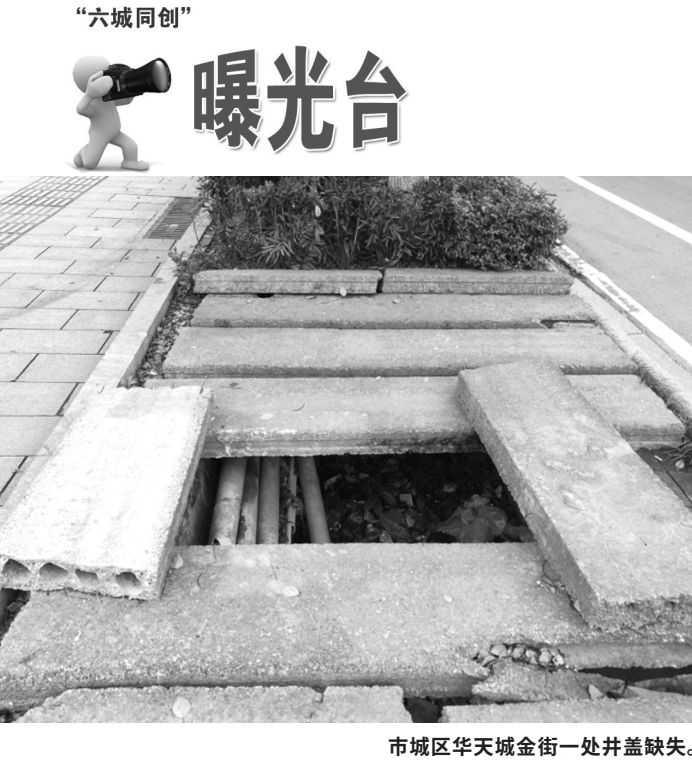
市城区华天城金街一处井盖缺失。
